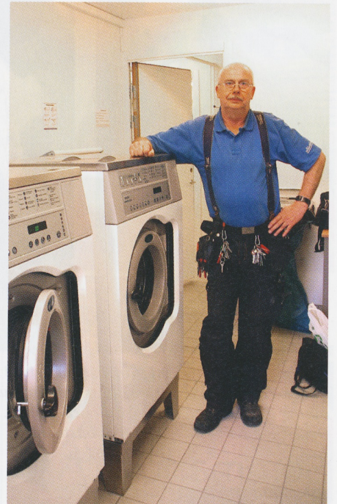
Sista arbetsdagen och Nisse gör en slutlig koll i den nyrenoverade tvättstugan på Nelsonstigen innan den öppnas för hyresgästerna.
