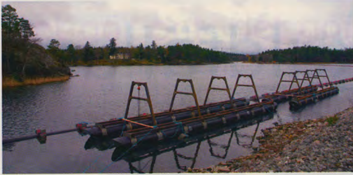
Arbete för en sjöledning som ska anslutas från Tjustvik över Baggensfjärden till Kil i Nacka. BILD: IW
