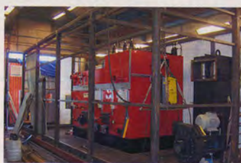
Den nya biobränslepannan är inbyggd i panncentralbyggnaden.
