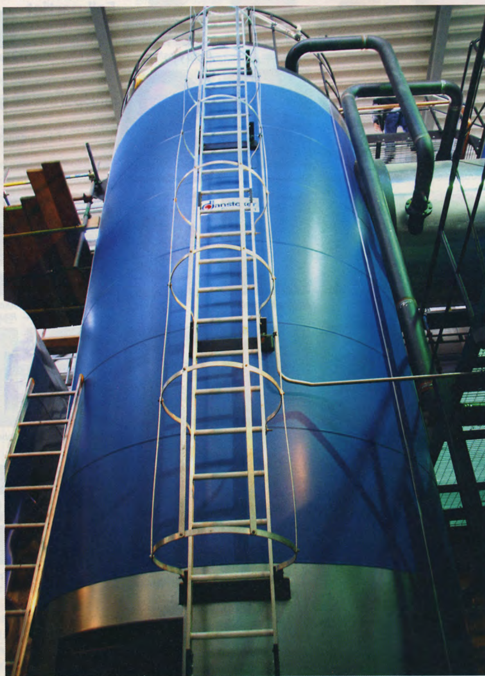
I anläggningen finns en flispanna på 7 MW och en rökgaskondensator som ger 1,5 MW samt att det tillförs 2 MW i form av deponigas från Kovik.
