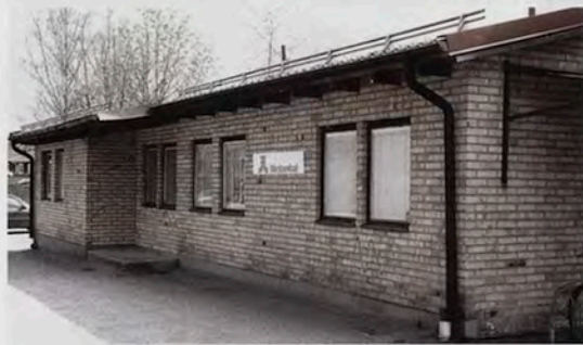
Vårdcentralen på Djurö byggs till och de befintliga lokalerna moderniseras. Bild IW
